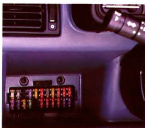
De zekeringen zijn gemakkelijk bereikbaar.
